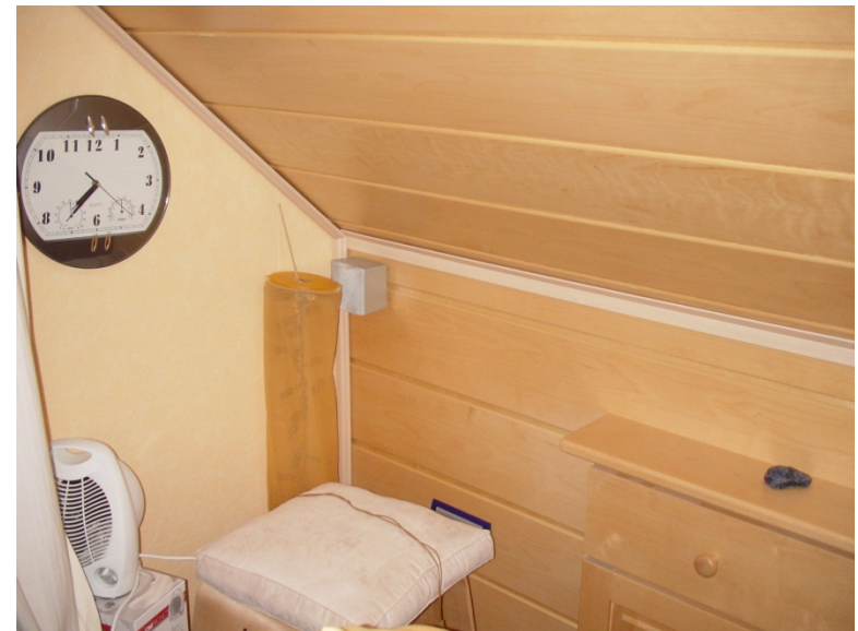
Kinderzimmer mit zusätzlicher Elektroheizung
